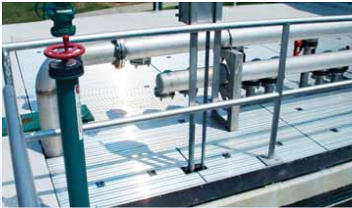
▲ Orangeburg WWTP - Orangeburg, SC
